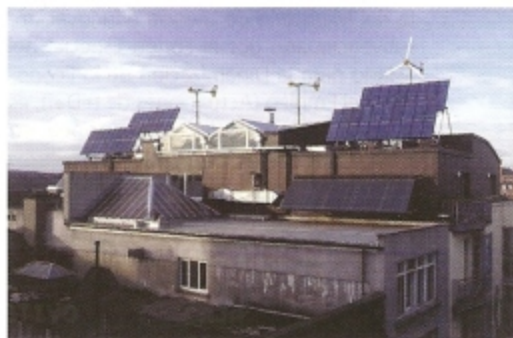
Integración de tecnología minieólica en edificación. Tejado dublinés con térmica fotovoltaica y minieólica.
